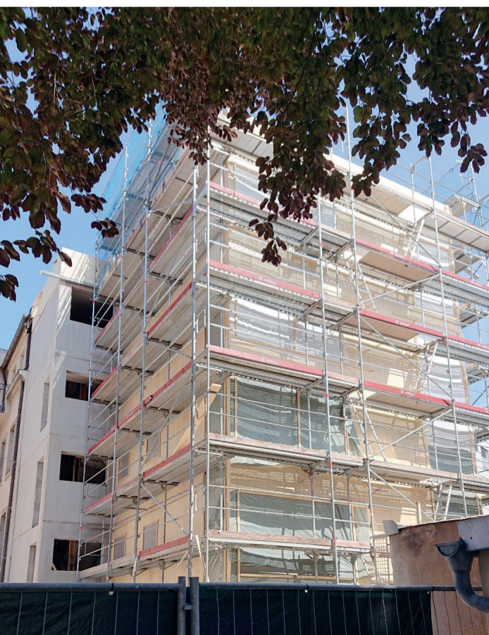
In dem neuen, fünfgeschossigen Wohnbau wird ein ganzheitliches Energiekonzept umgesetzt.
